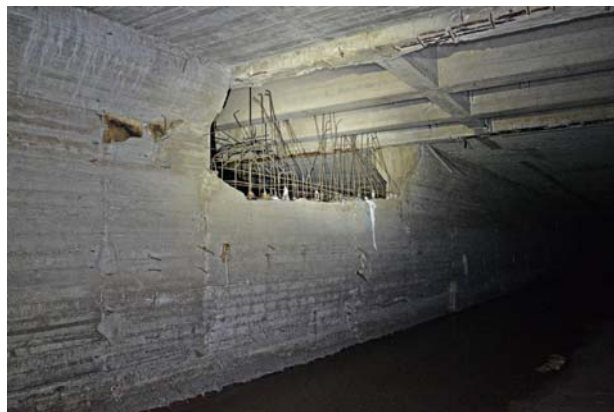
Θραύση μεσαίου τοιχίου για τοποθέτηση γέφυρας που δεν επισκευάστηκε
