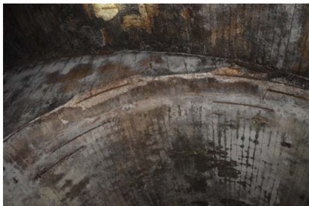
Αποκάλυψη και διάβρωση ράβδων οπλισμού.
