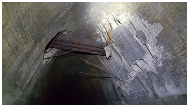
Αποκάλυψη και διάβρωση ράβδων οπλισμού & άγνωστης χρήσης σωλήνες.
